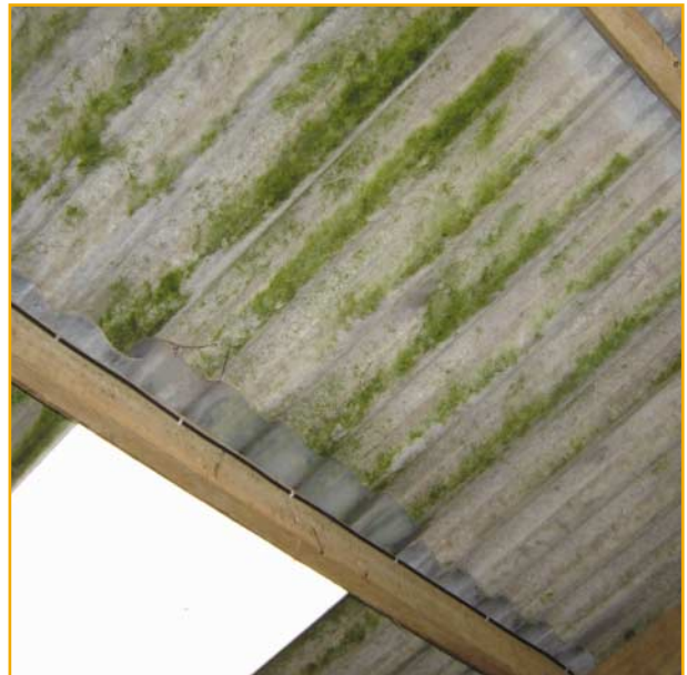
Plaques fibres-ciment dégradées (photo MSA 29)
